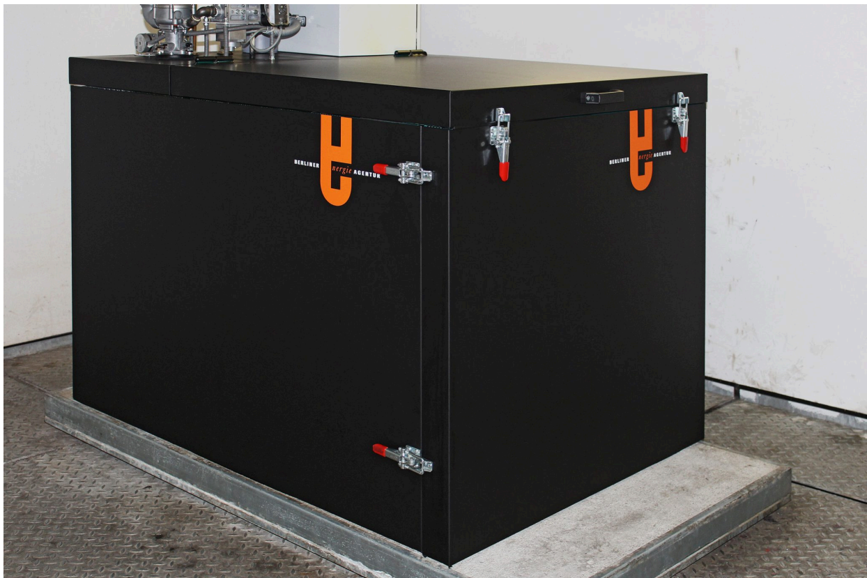
BHKW im Dachgeschoss der Bremer Höhe.
